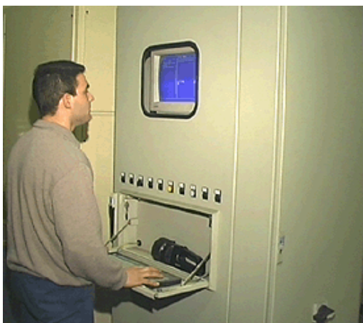
Pannello di controllo elettrico con microprocessore per il controllo automatico del ciclo di asciugamento.
